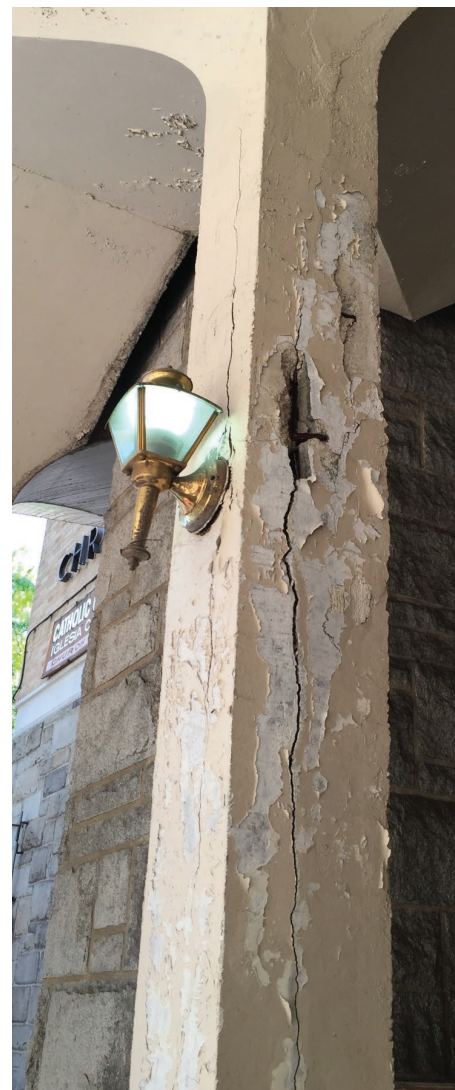
Columna que necesita reparación en la Iglesia Christ the King en Bronx.
